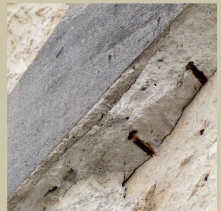
Enduit d'une courette rue St Jacques, Paris (Photographie Tiffanie Le Dantec)
